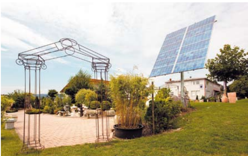
Zwei Nachführsysteme und zwei Dachanlagen befinden sich auf dem Gelände des Gartenbaubetriebs von Georg Saum. »Viele Kunden fragen nach unseren Erfahrungen«, erzählt er.
